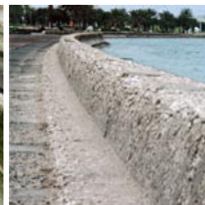
Degrado da acqua marina
