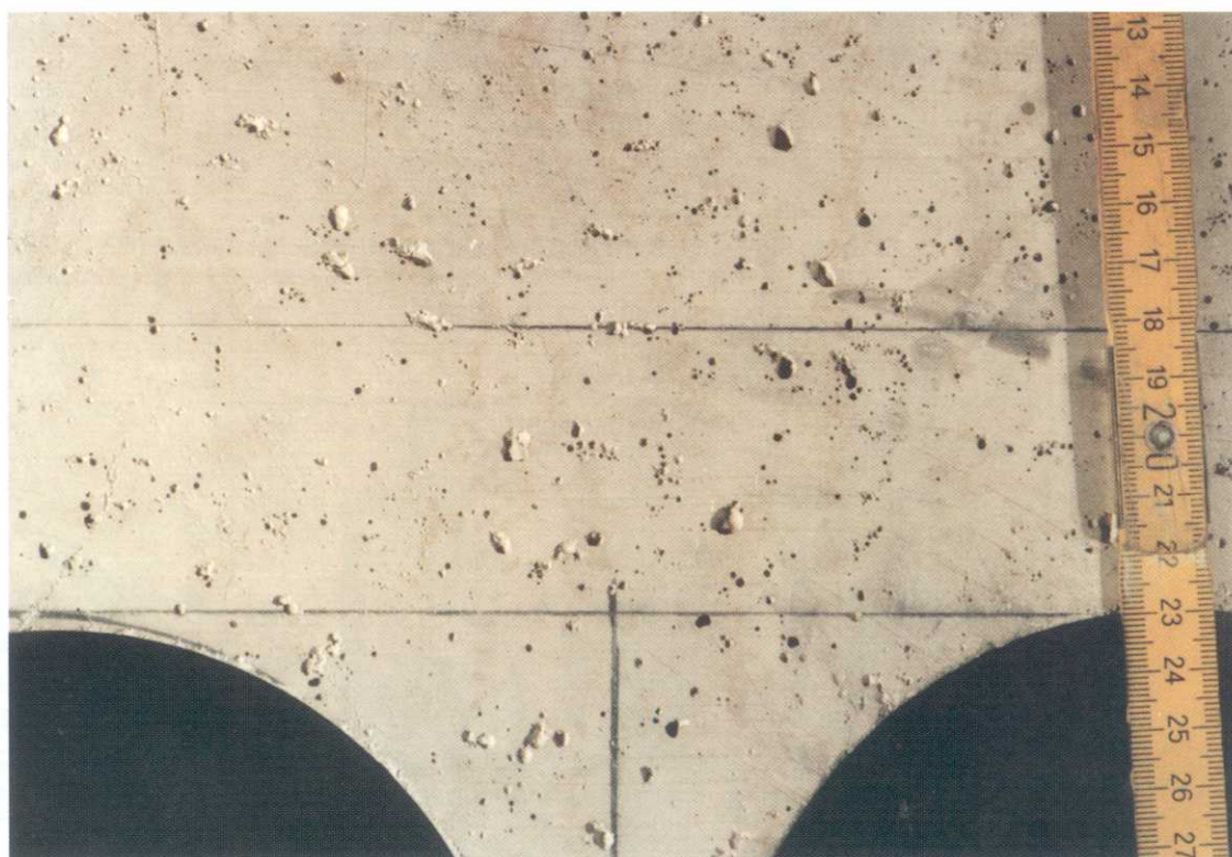
Foto 2: Ausschnitt aus Foto 1. Gegenüber der Fläche mit Schalungsbahn sind hier wesentlich mehr Luftporen vorhanden; vgl. Foto 4.
